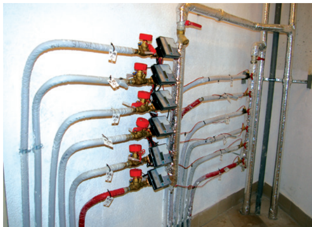
Figura 5.9. În interiorul unei încăperi tehnice de etaj, sunt ilustrate contoarele individuale de ET și conductele de încălzire separate pentru fiecare apartament, într-un bloc nou din Chișinău, conectat la SACET (sursa: Fotografii Encon).
