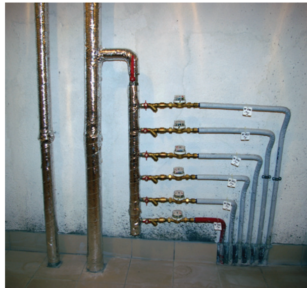
Figura 5.10. În interiorul unei încăperi tehnice de etaj, sunt prezentate coloanele magistrale de ACM și recirculare, contoarele individuale de ACM și distribuția ACM către apartamente, într-un bloc nou din Chișinău (sursa: Fotografii Encon).
