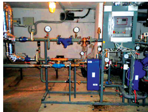
Figura 5.7. PTI conectat la SACET într-un bloc de locuințe din Chișinău (sursa: www.termocom.md).
